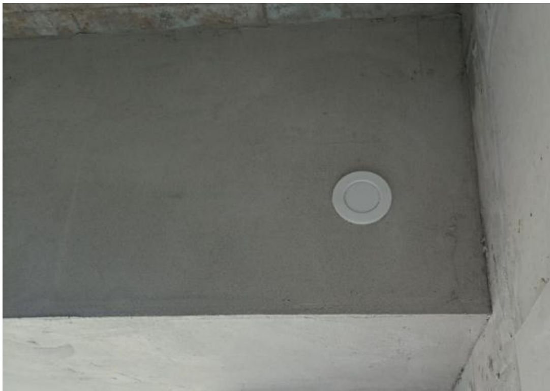
空调穿墙套管
