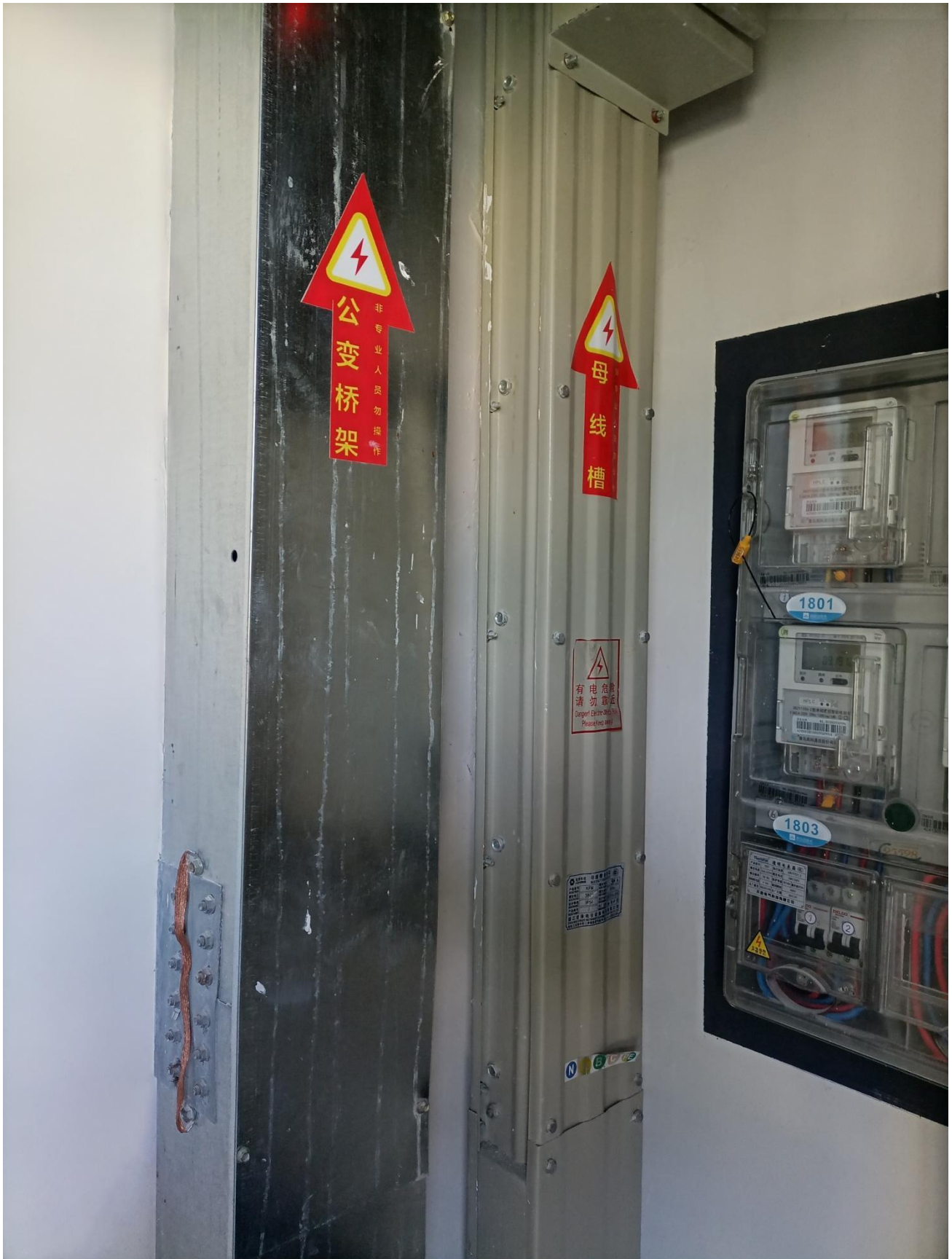
电井桥架、母线槽
